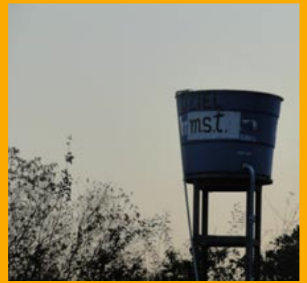
Adutora e Caixa D'água
